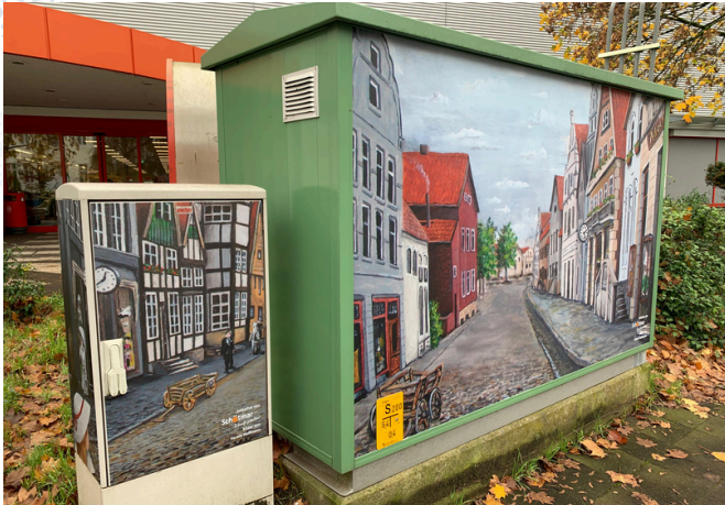
Foto: Stromkästen Nebeneingang HIT-Markt Quelle: Quartiersmanagement Schötmar
